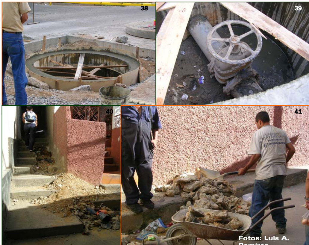
Figura 38. Reparaciones efectuadas a la tapa de concreto de una de las válvulas de la Aducción Guzmán Blanco, la cual permitía la entrada de aguas y desechos por fallas en la construcción original.
