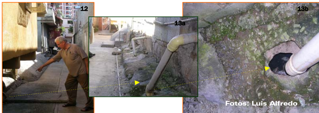
Figura 12. Oliveros muestra daños causados a las tuberías de aguas servidas por construcciones inadecuadas Figuras 13 (a-b). Detalle de las malas intervenciones en tubería de aguas servidas en el Sector Brisas del Paraíso de la Cota 905
