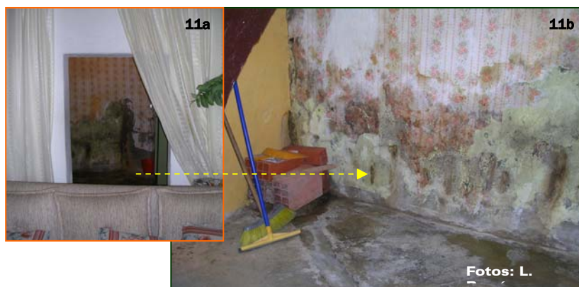
Figuras 11 (a-b). Daños causados por las filtraciones que han ganado terreno obligando al abandono de algunas áreas
