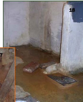
Figura 18. Aguas servidas corren libremente dentro de salas y cuartos en hogares donde se ha tenido que quitar muebles.
