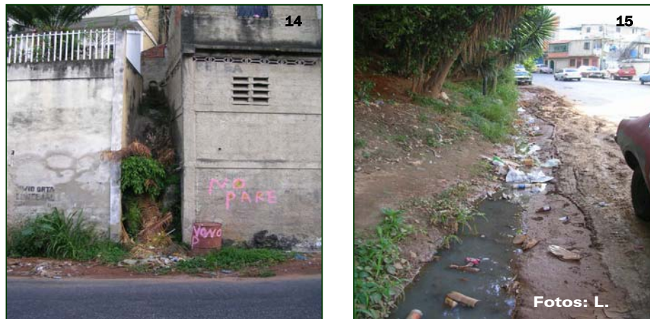
Figura 14. Basura y desechos crean obstrucciones de los cauces y torrenteras que vienen de las partes más altas Figura 15. Detalle de torrenteras tapiadas de lodo, basura y agua empozada que atenta contra salud de vecinos
