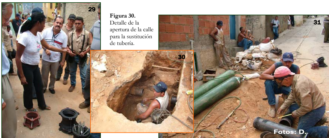
Figura 29. Habitante activó protesta para detener obras de reparación por el supuesto uso de materiales de una calidad inferior a la ofertada Figura 31. Obreros retomaron obra paralizada después que asistiera personal de la hidrológica para aclarar la situación.
