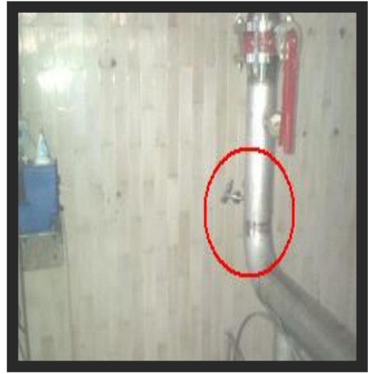
Dosificación de sulfato de Zinc a la línea de Mosto (Después)
