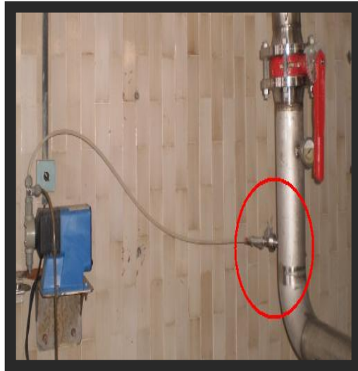
Dosificación de sulfato de Zinc a la línea de Mosto (Antes)
