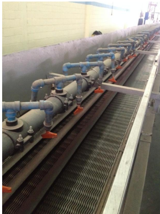
Anexo 2. Proceso de Extrusión (Piscina de enfriamiento)
