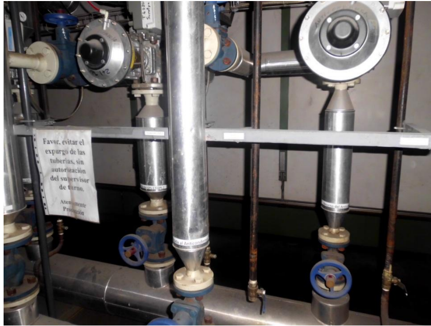
Anexo 15 (Identificación Tuberías Inferiores segundo grupo de bombas PURGA)
