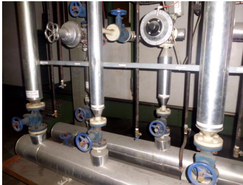
Anexo 16 (Identificación Tuberías Inferiores segundo grupo de bombas)
