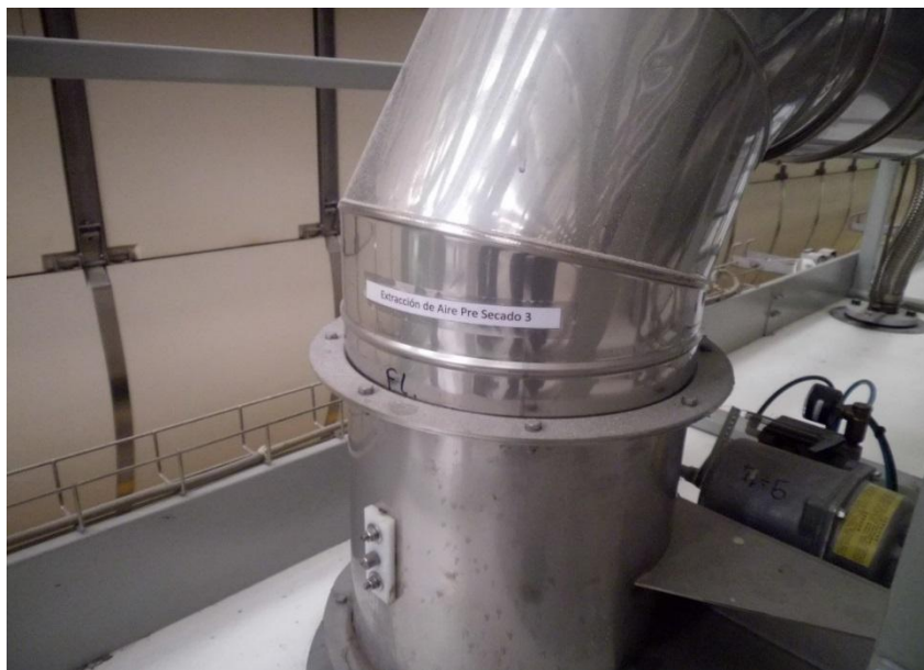
Anexo 21 (Identificación Extracción de aire)
