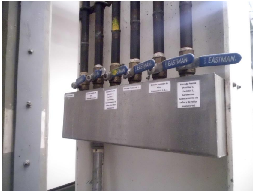
Anexo 13 (Identificación Tuberías Inferiores Primer grupo de bombas PURGA)
