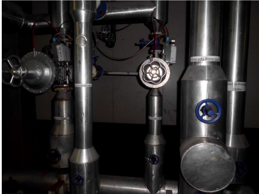
Anexo 17 (Identificación Tuberías Inferiores tercer grupo de bombas)
